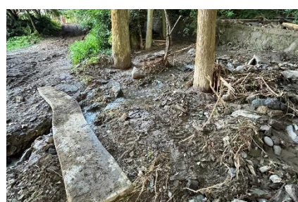
橋 被災直後（藍生庵提供）
